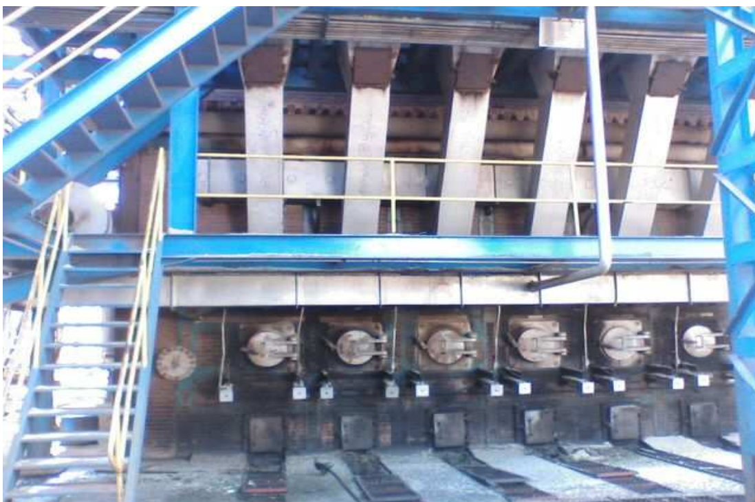
Foto 2 – Caldeira onde o bagaço é queimado, visão parcial
